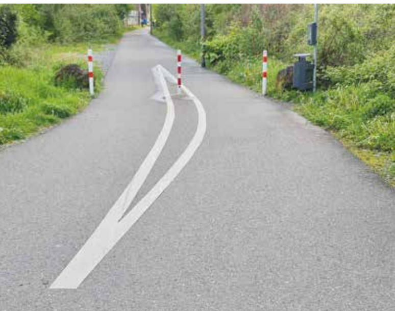
Gute Erkennbarkeit des Sperrpfostens durch umlaufende Markierungen – Foto: Christian Eckert
